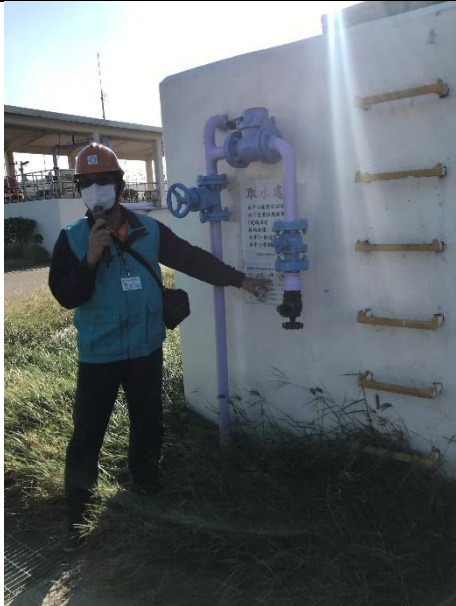
照片註解:提供回收水給民眾取用，建議使用在澆花、洗車上。
